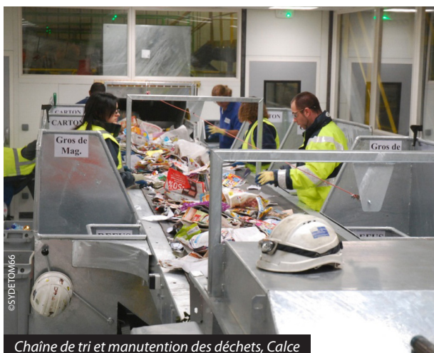
Chaîne de tri et manutention des déchets, Calce
